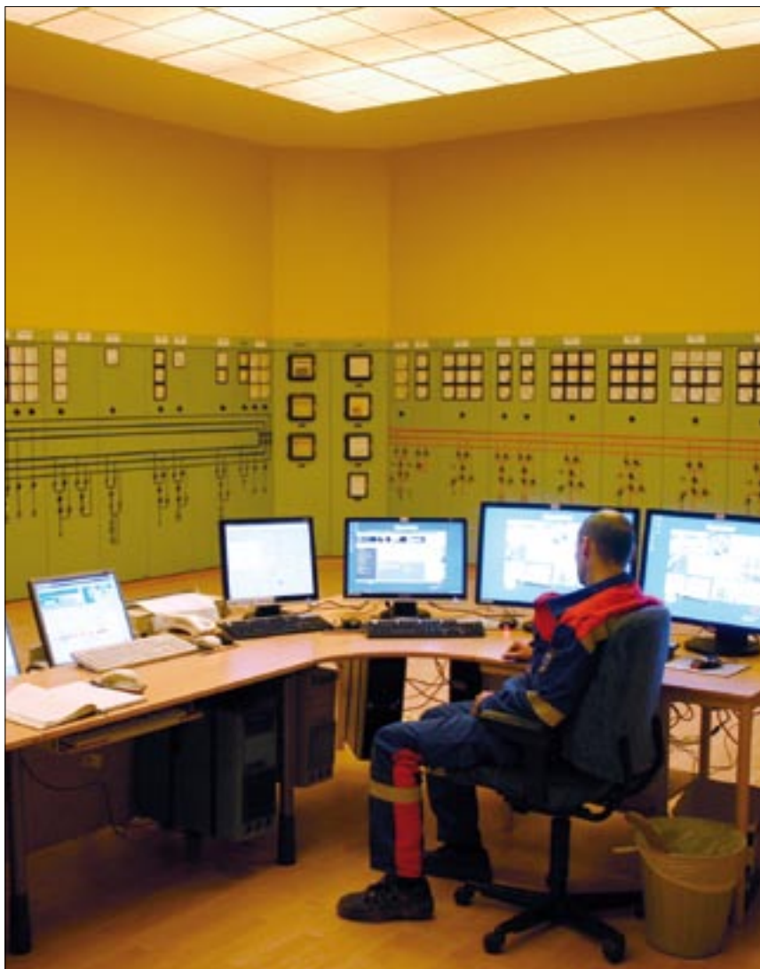
Moderne skjermbasert styring overtar for det gamle tavlesystemet.
