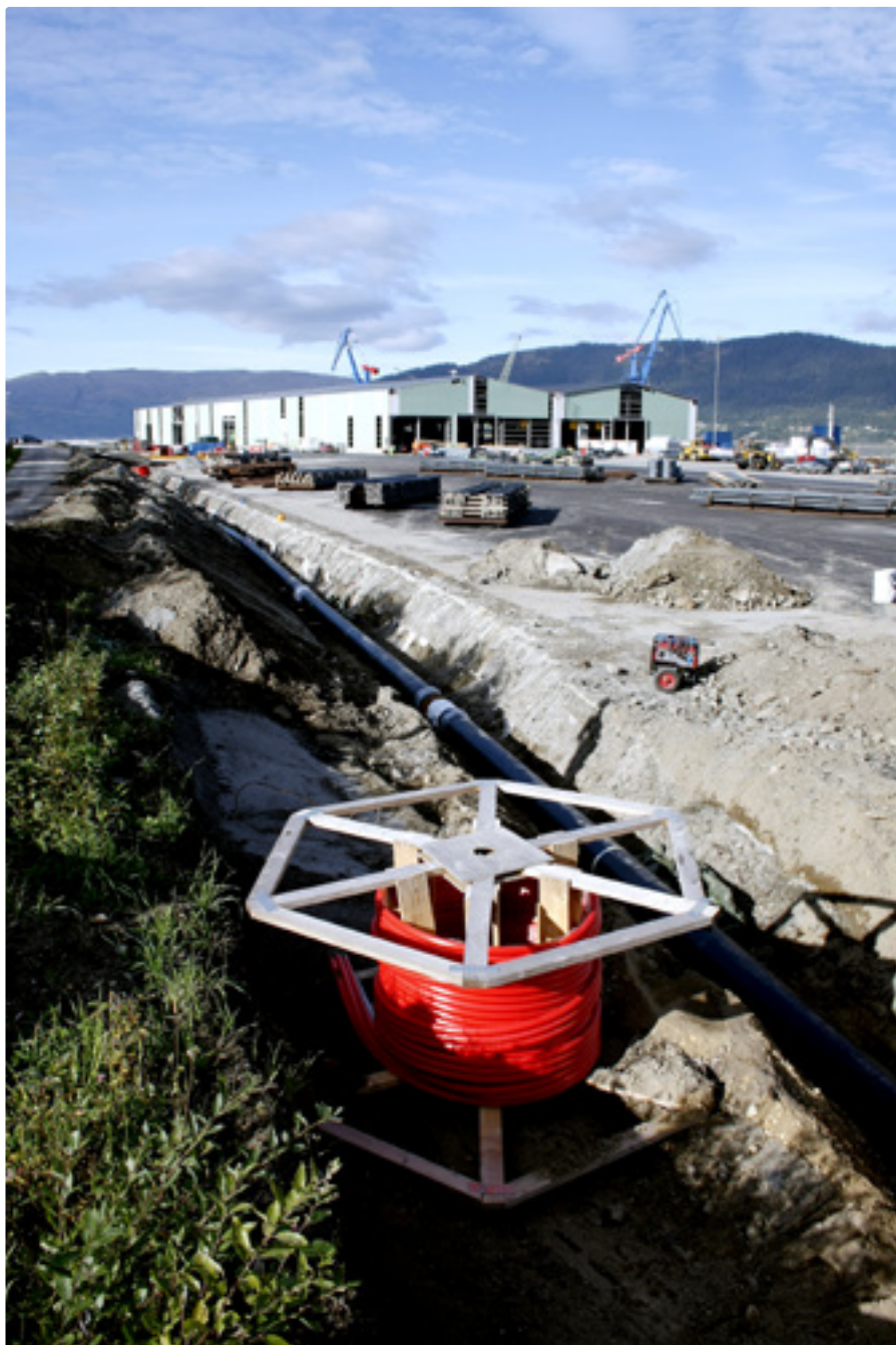
MIP Service og IT har i 2013 gjennomført oppgradering av fibernettet; MIP-ringen. Dette gir bedrifter i Mo Industripark en sikker kobling til internett, ti ganger større kapasitet og høyere hastigheter, god datasikkerhet og meget lav risiko for langvarig driftsstans. Dette vil gi strategiske muligheter for alle bedrifter i Mo Industripark.
