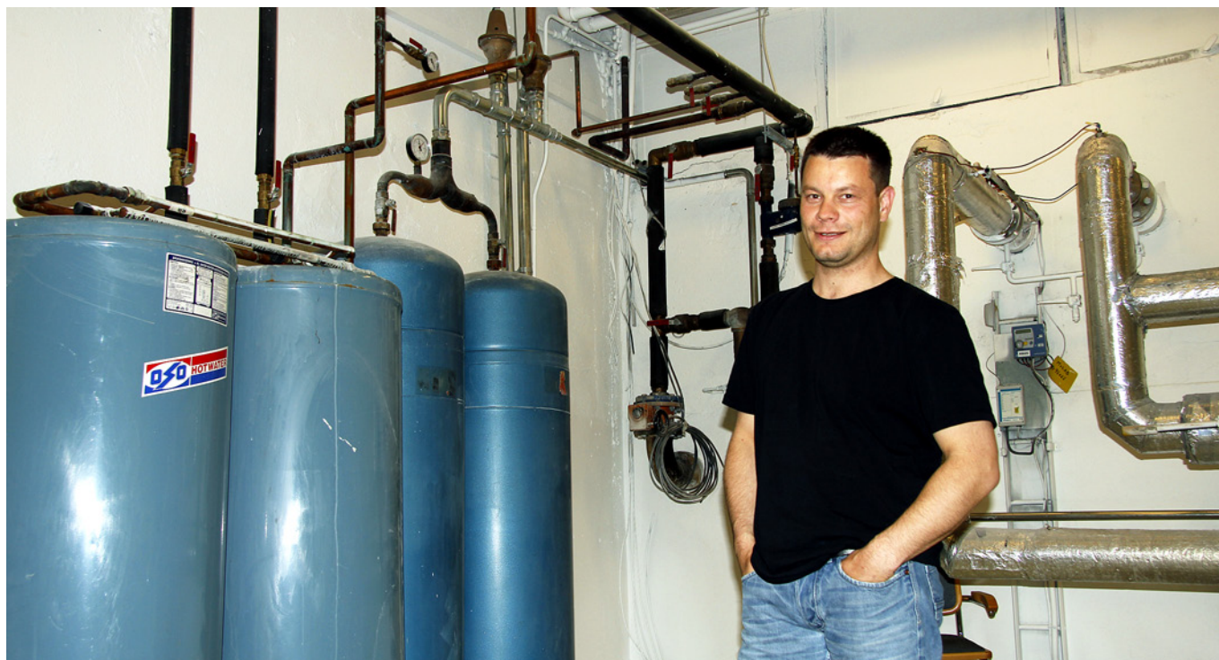
Det er i 2011 gjennomført flere tiltak for å forhindre legionella. Her avdelingsingeniør Steinar Bech-Hanssen ved en av de installasjonene som er rustet opp.
