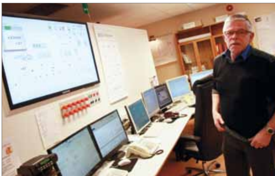
Magne Johansen ved kontrollrommet i Energisentralen.
