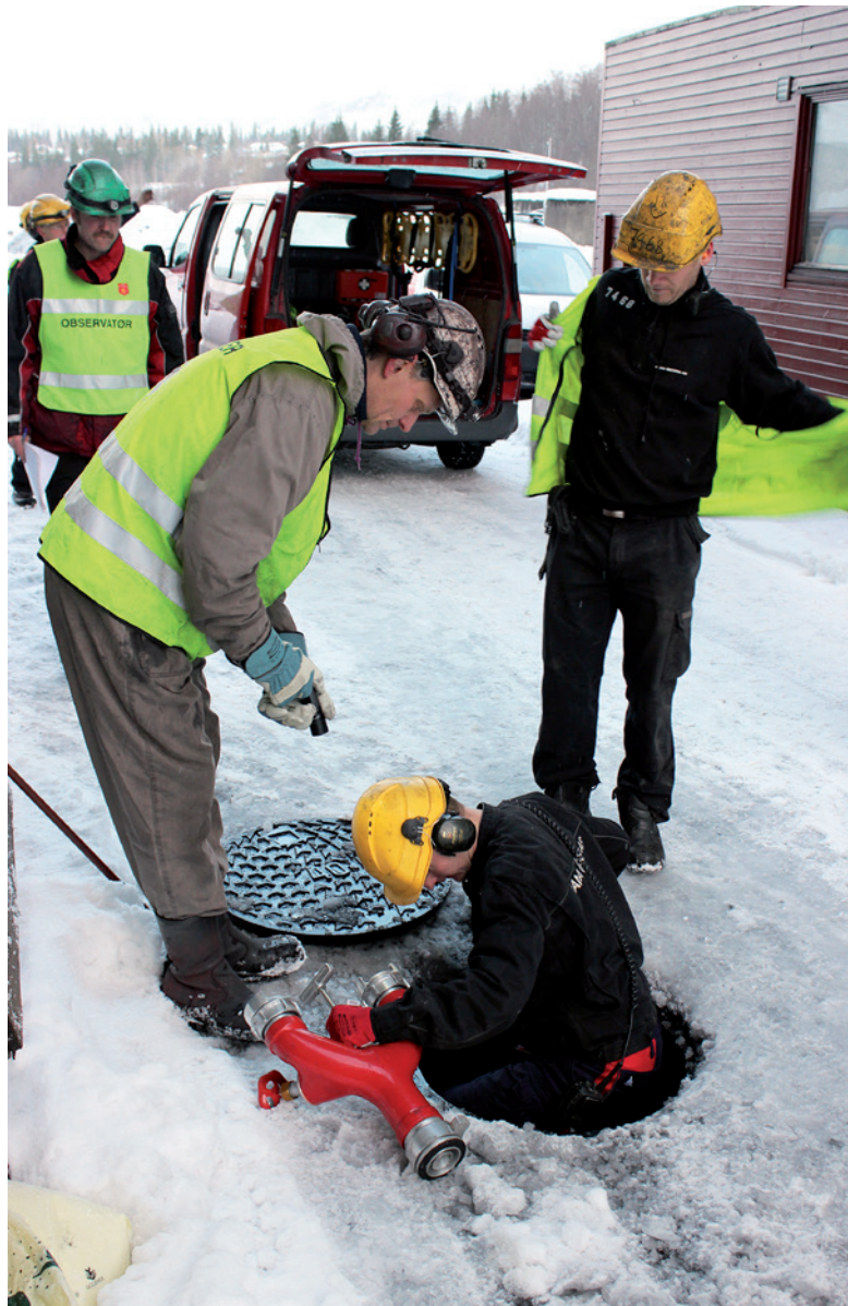
Fra brannøvelsen i november ved oppredningsverket, med den fjerde gruppa. Her deltok Kai Arne Brunmoen, Martin Moen, Jørn-Ove Pedersen, Åge Pedersen, Jonny André Henriksen, innsatsleder Svenn Langfjell og innsatsleder 2 Kenneth Madsen. I tillegg deltok observator Håvard Lysheim. Instruktør var Svein Joar Almli fra MIP Sikkerhetssenter i Mo Industripark AS.
