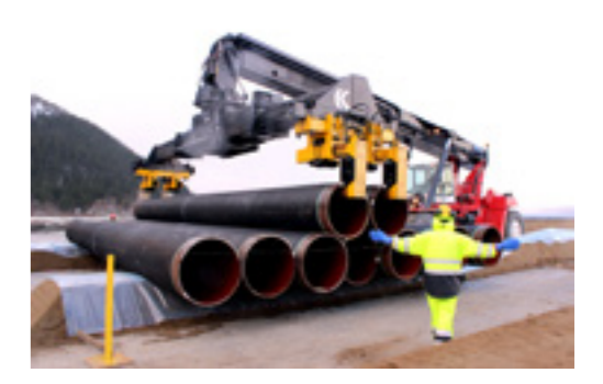
Effektiv utlegging fra Reach stackeren, der en operatør dirigerer slik at rørene legges pent på plass. Her legges det niende og tiende røret, og i alt er det plassert 4370 rør ut på lagerområdet.
