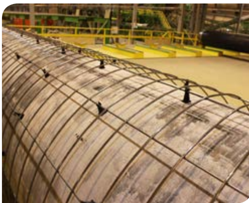
Under «pegging» av rørene oppsto det statisk elektrisitet. «Pegging» er prosessen med å feste små plastikklosser mellom rør og armering, for å ha lik avstand mellom disse under coatingen.
