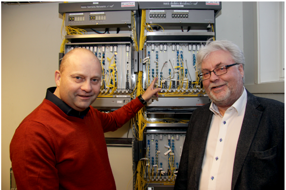
- Fra vårt ståsted i Mo Industripark mener vi regjeringen fortjener ros for sitt framlegg om redusert elavgift for datasentre, sier Arve Ulriksen, adm. dir. i Mo Industripark AS. Han ser fram til at det kan trekkes mange datakabler i et stort datasenter i Mo i Rana i framtiden, og her gleder han seg over regjeringens framlegg sammen med ordfører Kai Henriksen (H) i Rana kommune.
