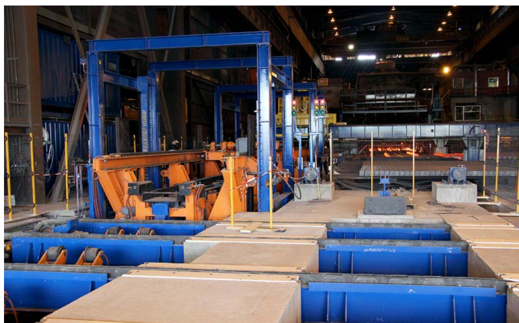
Bildet viser anlegget i Stålverket, der de varme emnene skal settes inn i termoboksene. Termoboksene settes inn til høyre og tas ut til venstre i bildet.
