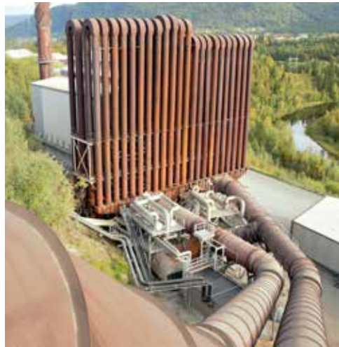
Mo Fjernvarme tar stadig nye grep for å kunne benytte overskuddsenergien fra industrien på nye måter.
