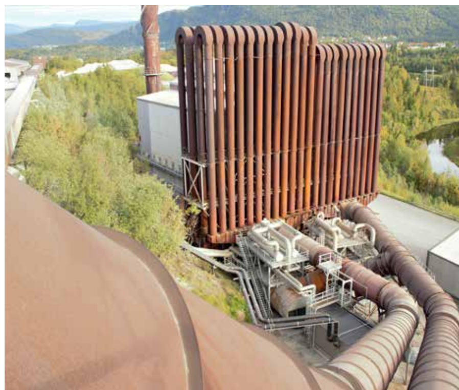
Her går overskuddsvarmen fra smelteovnene til Elkem i store rør ned til Mo Fjernvarme som produserer fjernvarmen og distribuerer den til mange av de største byggene i Mo i Rana. Noen av byggene som holdes varme er Helgelandssykehuset, Campus Helgeland, Rådhuset, Nasjonalbiblioteket, Polarsirkelen videregående skole, barneskolene på Selfors og Gruben og Mo ungdomsskole.
